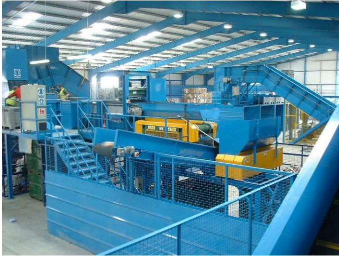
Figuur 9: een wervelstroom-scheidingsinstallatie.
