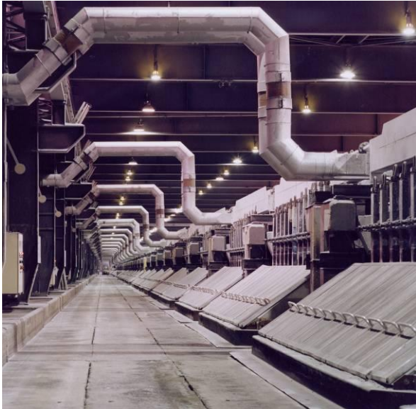
Figuur 4: een hal met elektrolysecellen.
